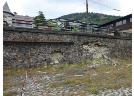
Schäden an der Stützmauer des unteren Werkhofs des Erzbergwerks Rammelsberg. Foto: C. Reulecke, Niedersächsisches Landesamt für Denkmalpflege (NLD).
